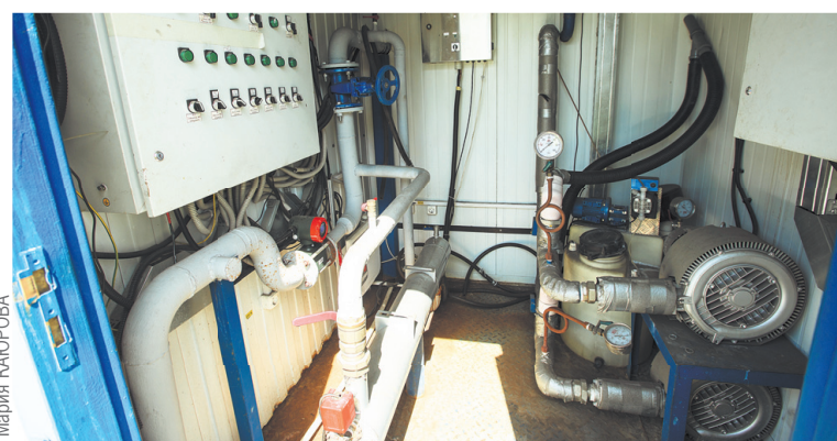
Очистные сооружения на территории порта.
